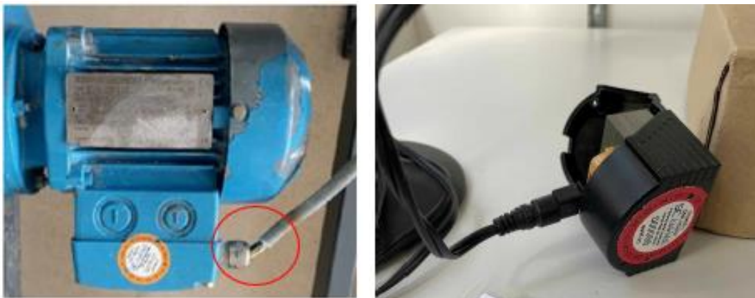
Ausgerissene Kabel und defekte Gehäuse: häufig angetroffene Mängel. Bilder: E+S.
